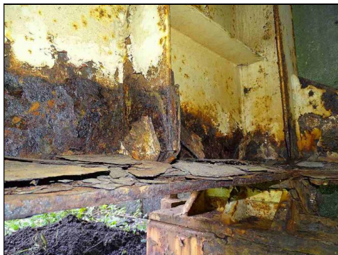
鋼桁の腐食等
