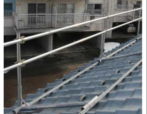
② 転落防止柵
