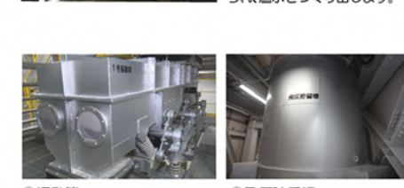
⑫振動篩 焼却炉から送られてきた灰は、篩にかけてセメント不適合物を取り除きます。
