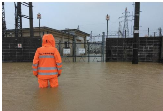
直江津変電所屋外冠水状況
