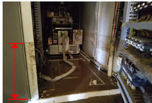
直江津変電所内部（約50cm冠水）
